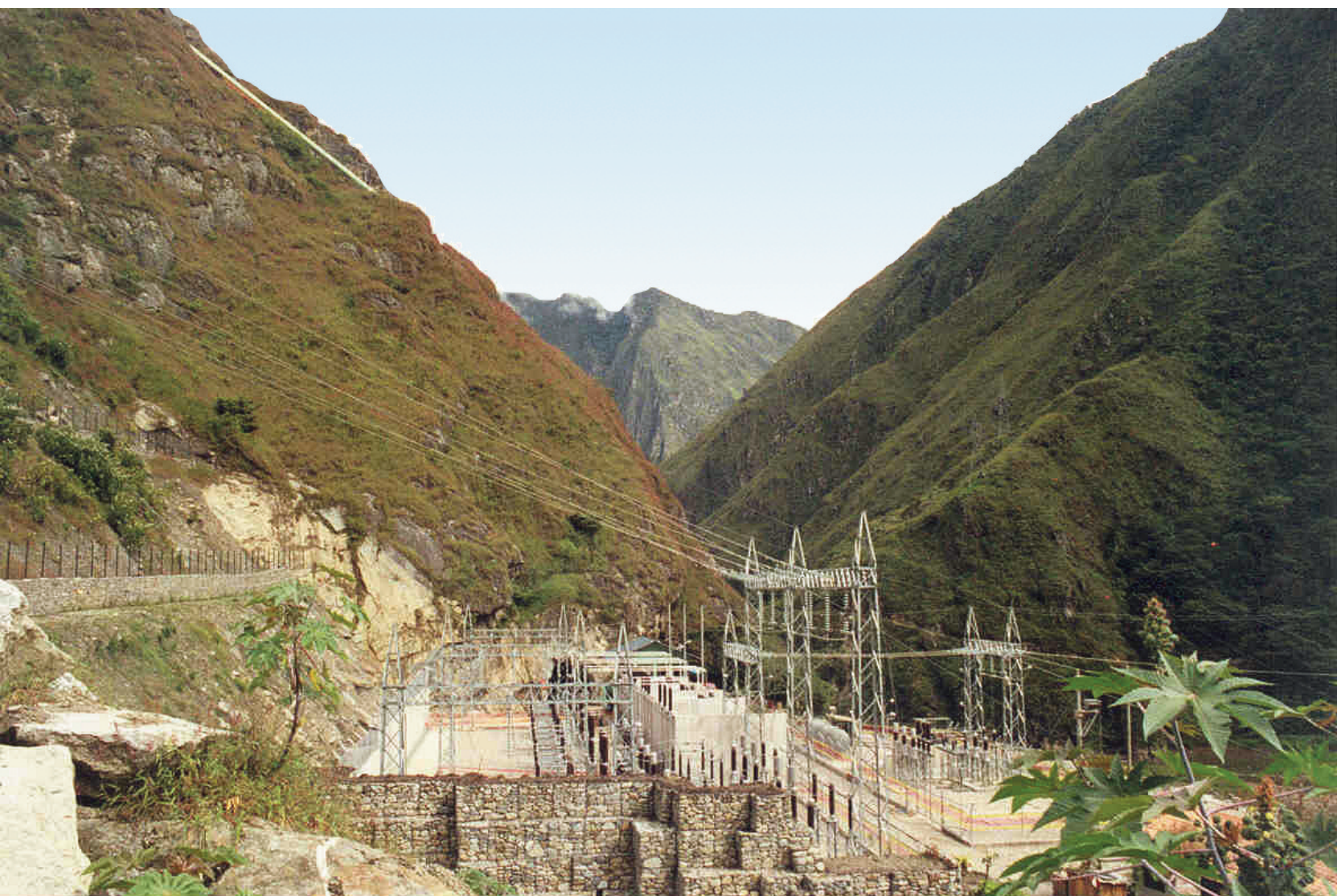
Patio de llaves - Subestación Machupicchu
