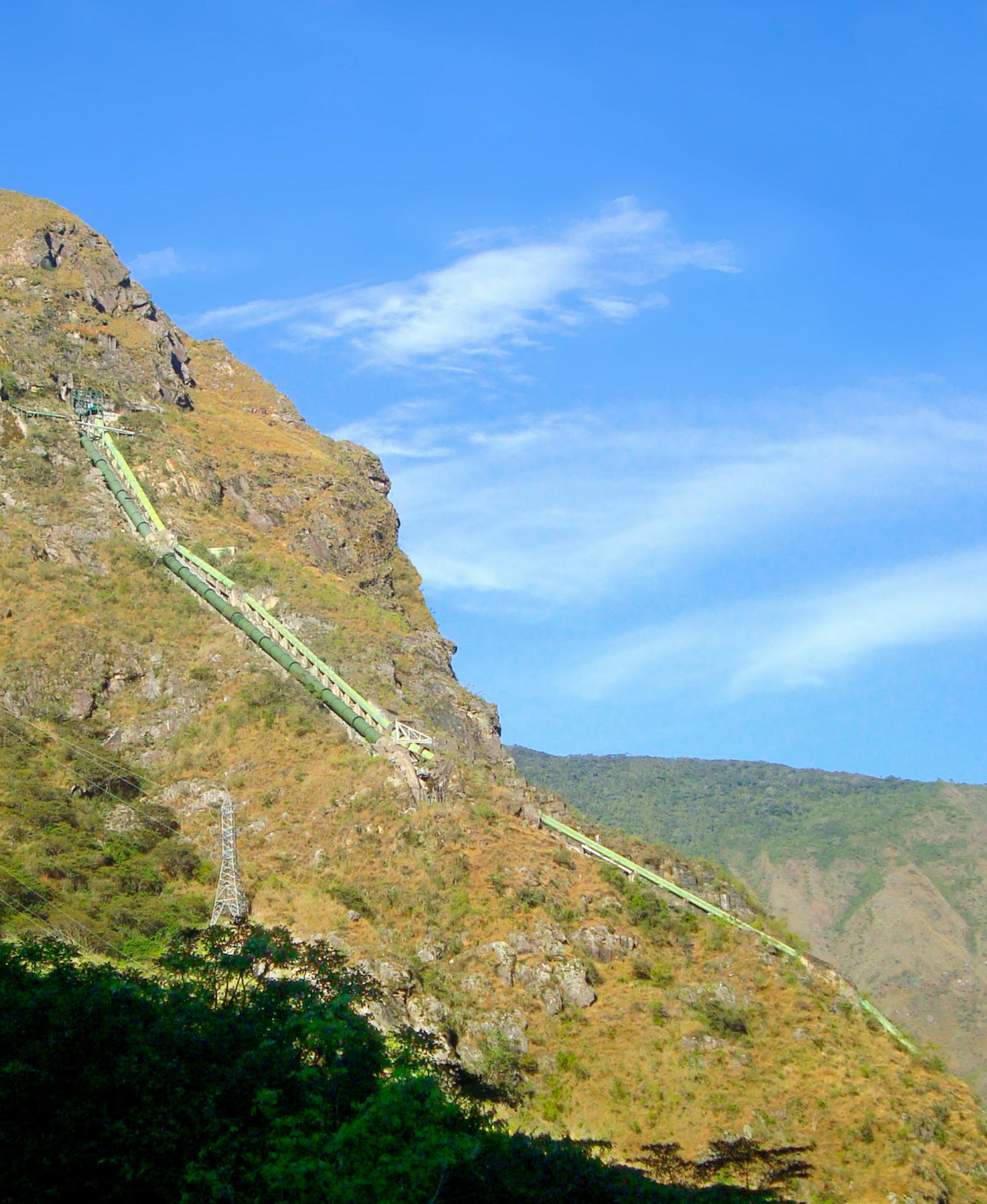
Tuberías forzadas de los grupos de la Central Hidroeléctrica Machupicchu.
