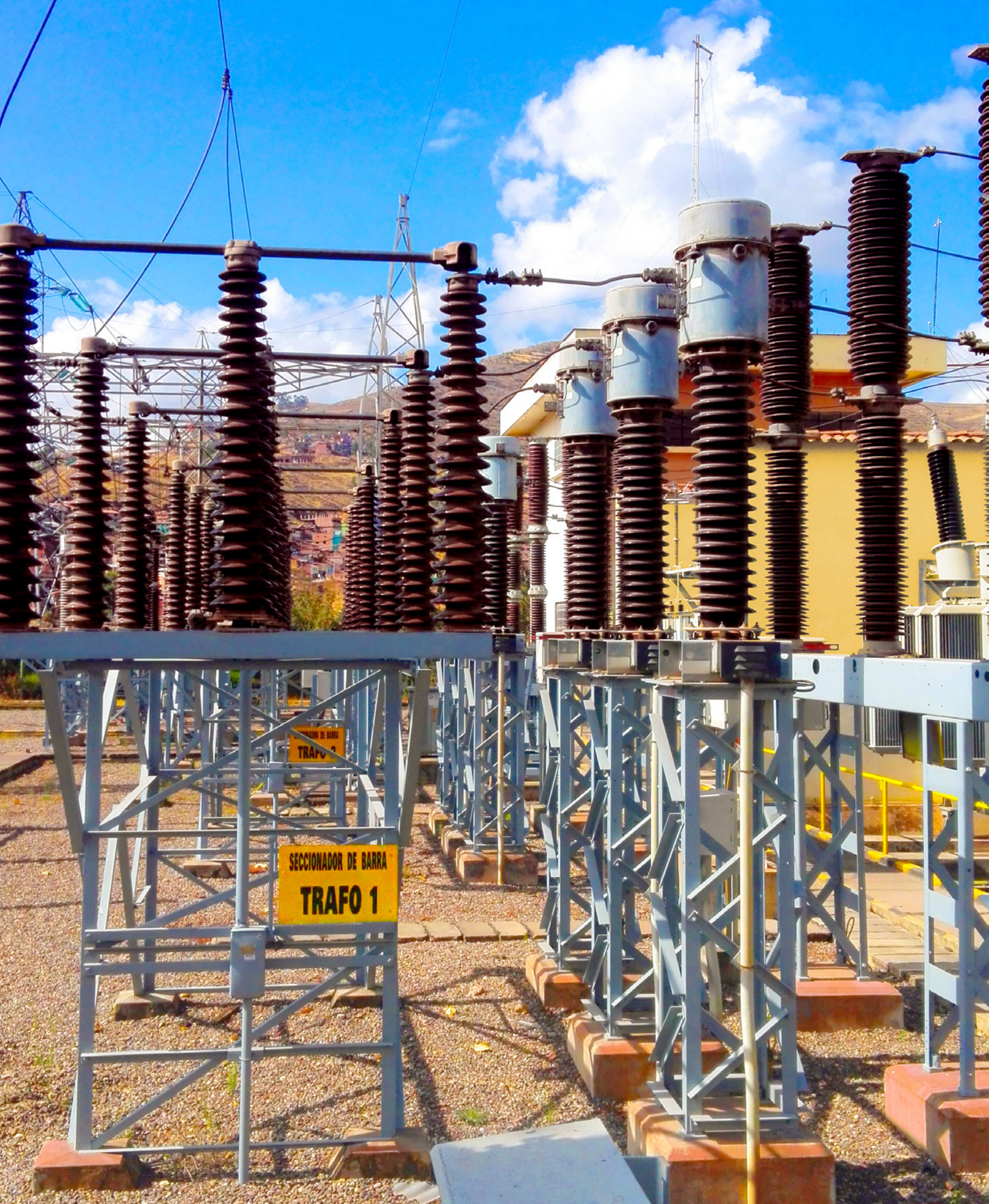
Patio de llaves, Central Térmica Dolorespata
