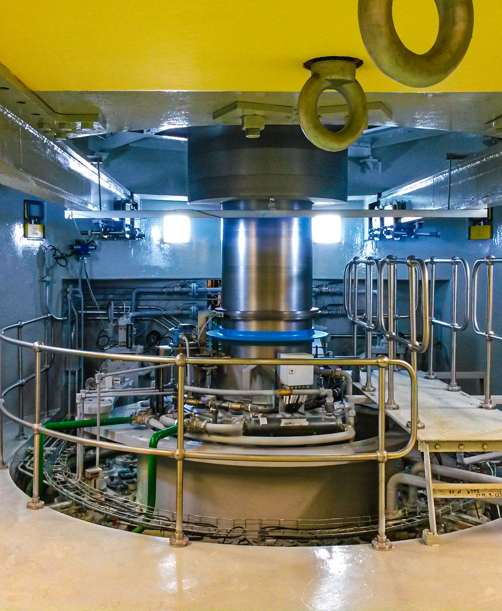
Eje de transmisión de Tubería a Generador - Central Hidroeléctrica Machupicchu
